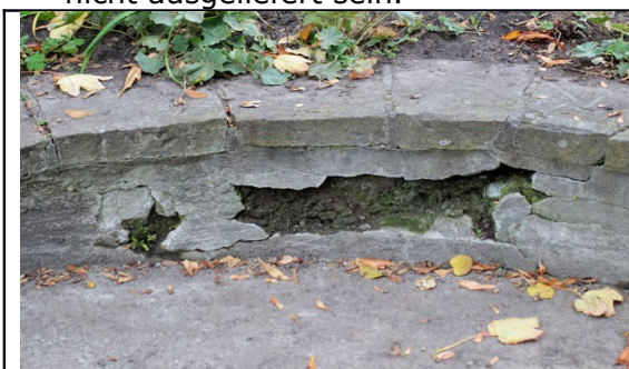
Risse, Öffnungen im Rundbeckenrand © Bürger für den Lietzensee
